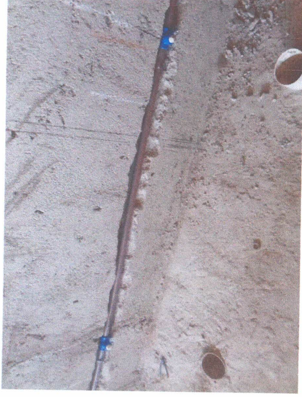
Tubulações Instalações Hidráulicas
